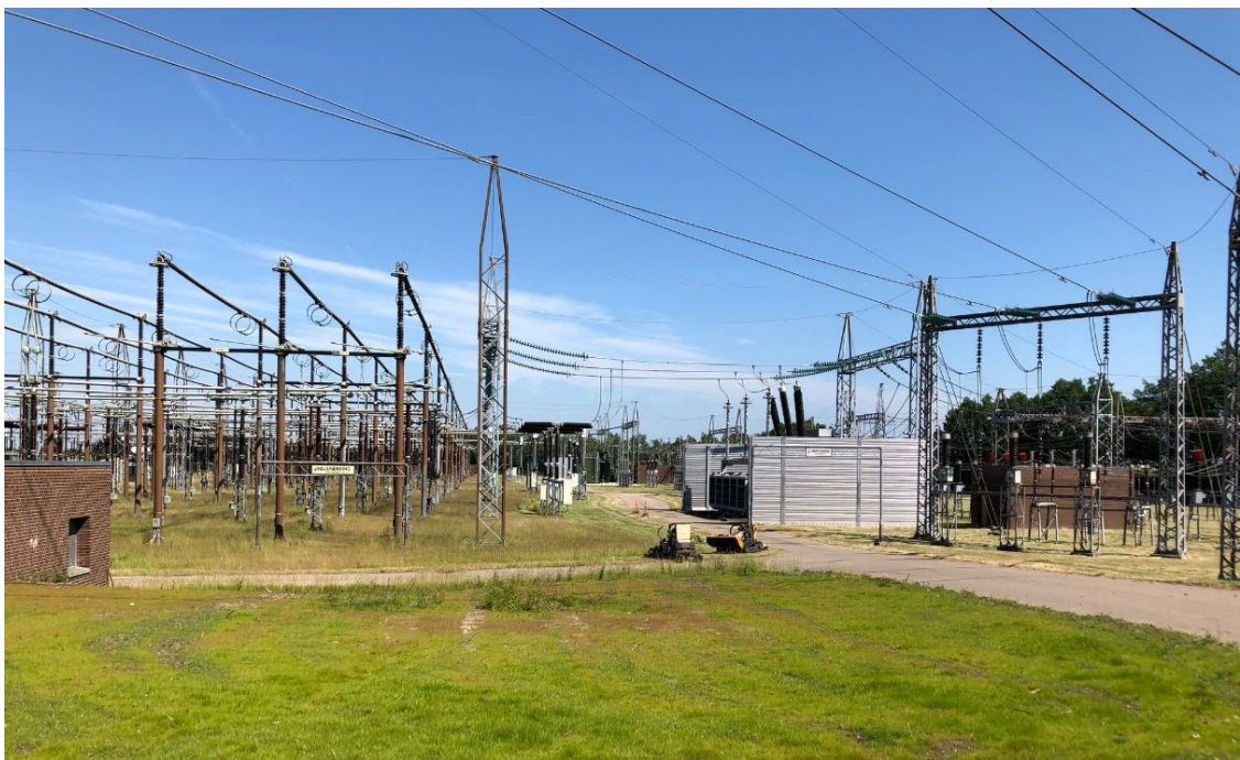
Figur 4.5: Støjskærmning på den eksisterende Hovegård Højspændingsstation.
