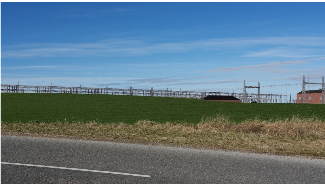
Figur 4.25 Et eksempel på, hvor synligt udvidelsen af Hovegård Højspændingsstation mod øst kan blive set fra sydøst. I eksemplet er det åbne anlæg placeret med stor afstand til arealreservationens østlige grænse, hvorved terrænet kan have en delvist afskærmende effekt (Illustration: NIRAS A/S).
