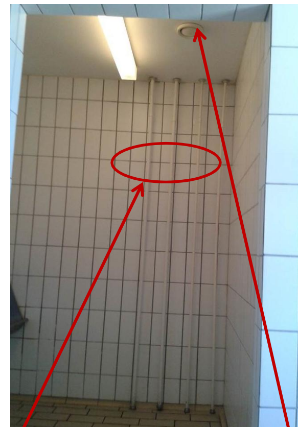
4 varme lodrette rør udsugning i loft
