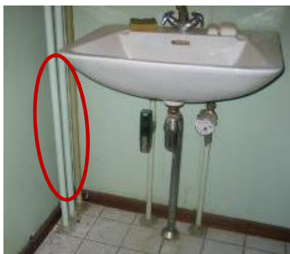
Bolig fra 1970, uisol. rør
