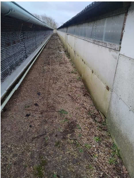
Billede 4—20. Minkfarme 4 – med asbestholdige facader.
