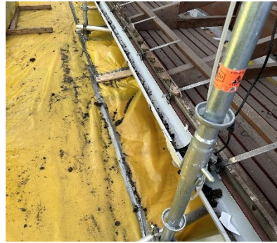
Billede 4—12. Støv og asbestholdig mos på trods af skånsom håndtering
