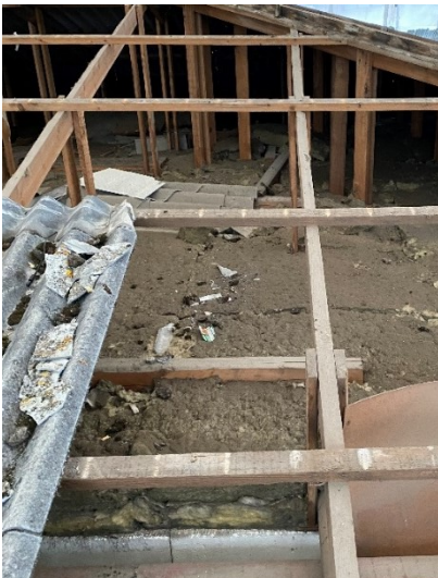
Billede 4—9. Arbejdsområde – meget støv på isolering. Knækkede plader og mos på asbestplader – dette er et generelt gængs billede på alle typer projekter.
