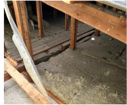
Billede 4—13. Større mængder af støv under tagpladerne på overfladen af isolering
