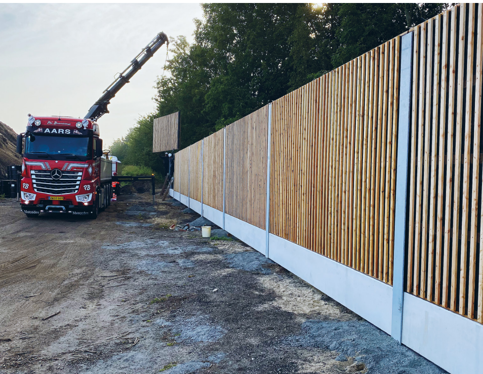
Figur 3: Eksempel på træstøjskærm fra den tyske producent Fahlenkamp. Her rejst ved NCC Industry i Danmark.
