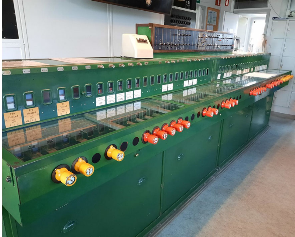
Ældre sikringsanlæg på Struer Station. Anlægget er taget ud af drift i februar 2021.
