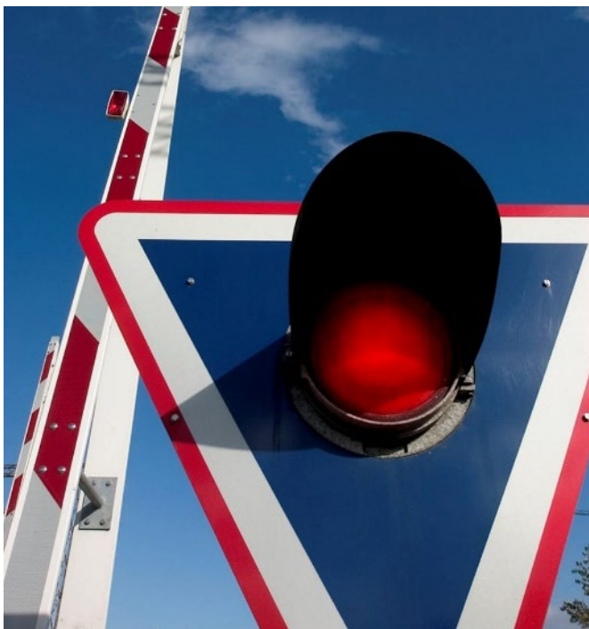
Sikringsanlæg i overkørsel.
