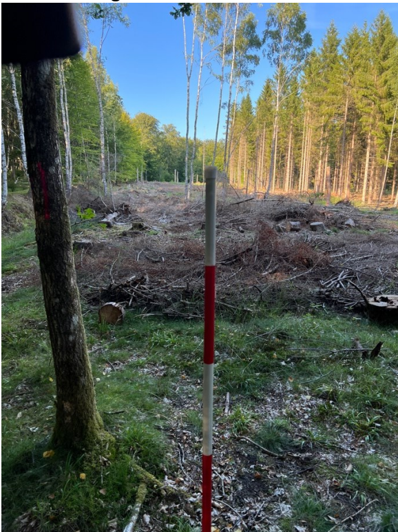
Billede 2: Taget mod øst, hvor der er ryddet en bred trace i skoven øst for Mårum Tinghuse Station for at give plads til hegnet. Den rød/hvide pæl markerer hjørnestolpen i indhegningen, som skal fortsætte langs banelegemet mod syd.
