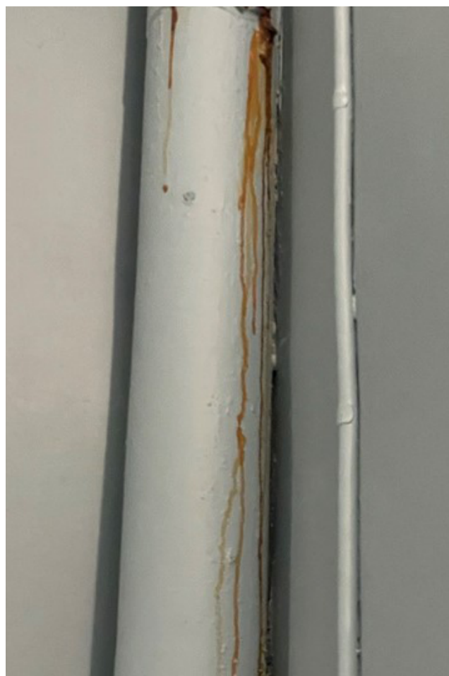
Eksempel på faldstamme som er nymalet, men som pga. alder er utæt.
