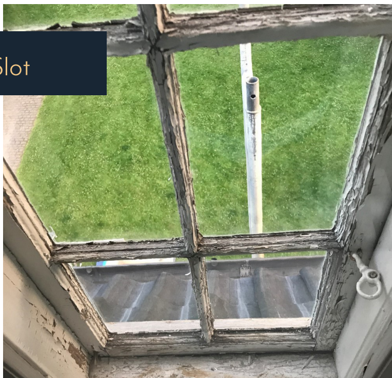
Eksempel på hvordan et vindue så ud inden restaurering ved overtagelsen i juli 2017.
