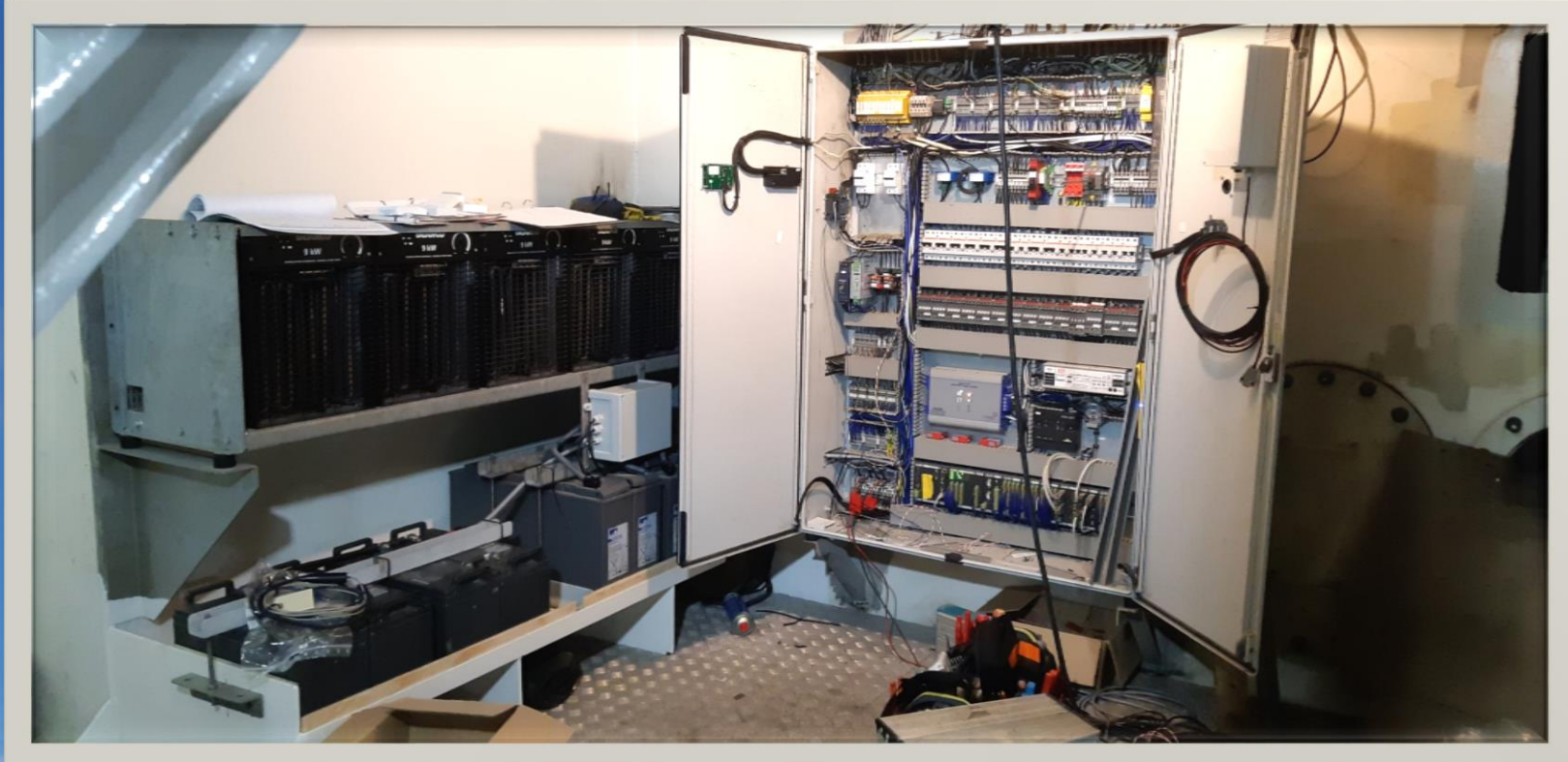
Stort og tørt maskinrum til det tekniske udstyr
