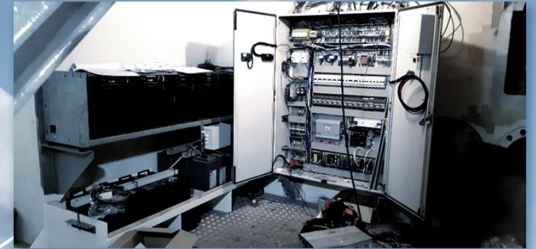
Stort og tørt maskinrum til det tekniske udstyr
