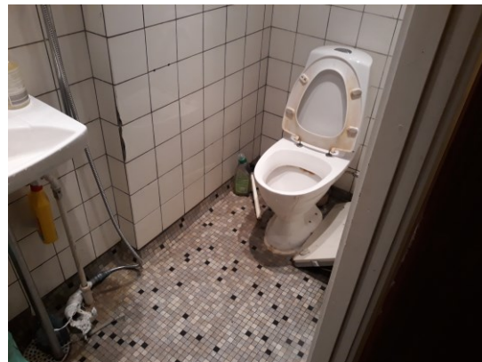
Ingen dør til toiletet, bemærk at varmen er fra et el-panel stillet på gulvet ved siden af toiletet.
