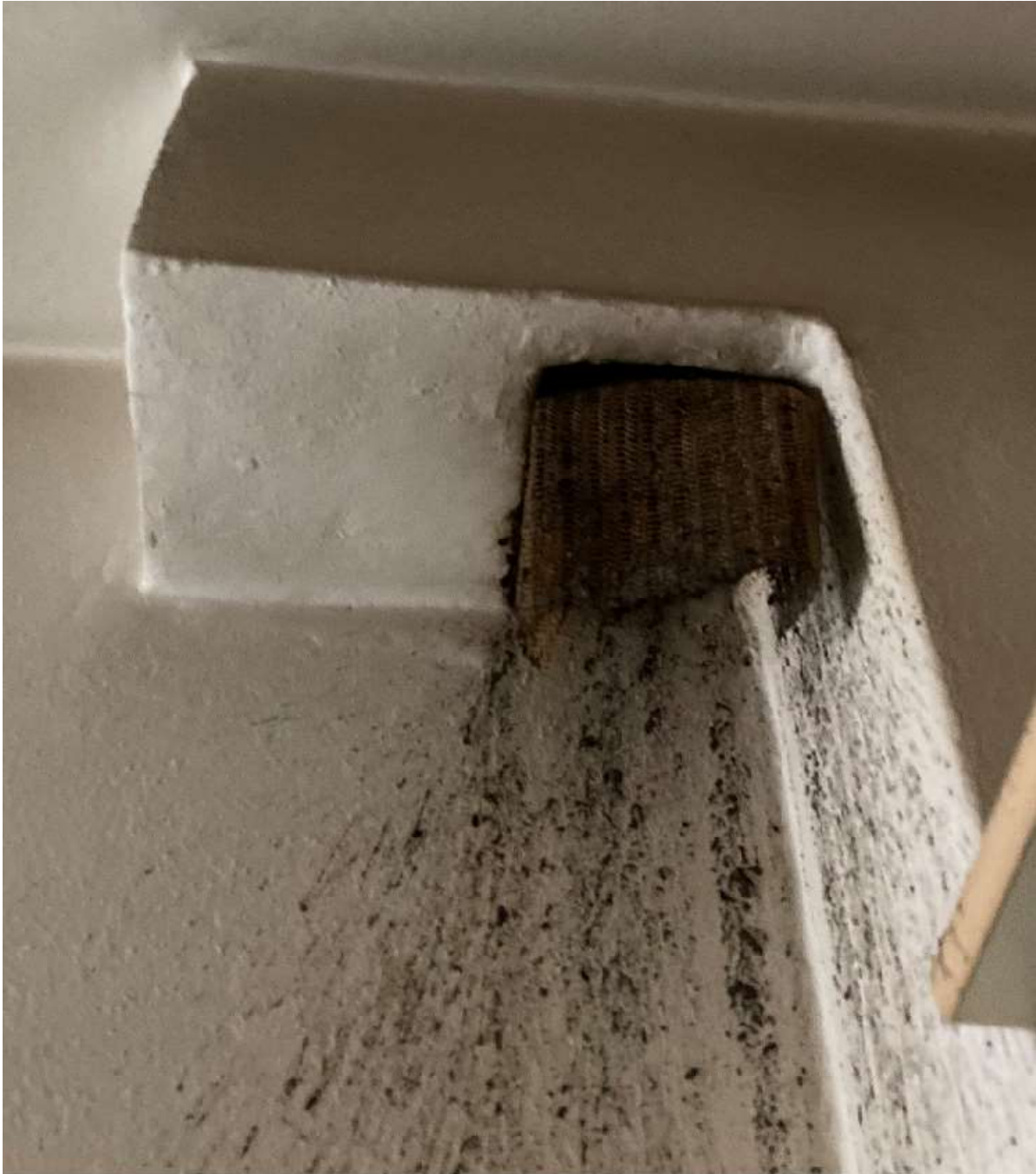
Figur 21 DBI – 28. marts 2022. Ventilationskanal i køkken. Slukningsvand fra slukning af brand i spidsloftet.
