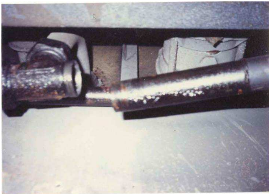
Foto nr. 1: Returolierøret med afgrening til betjeningspanel på bildæk. Røret trukket ud af skæringssamlingen til T-stykket.
