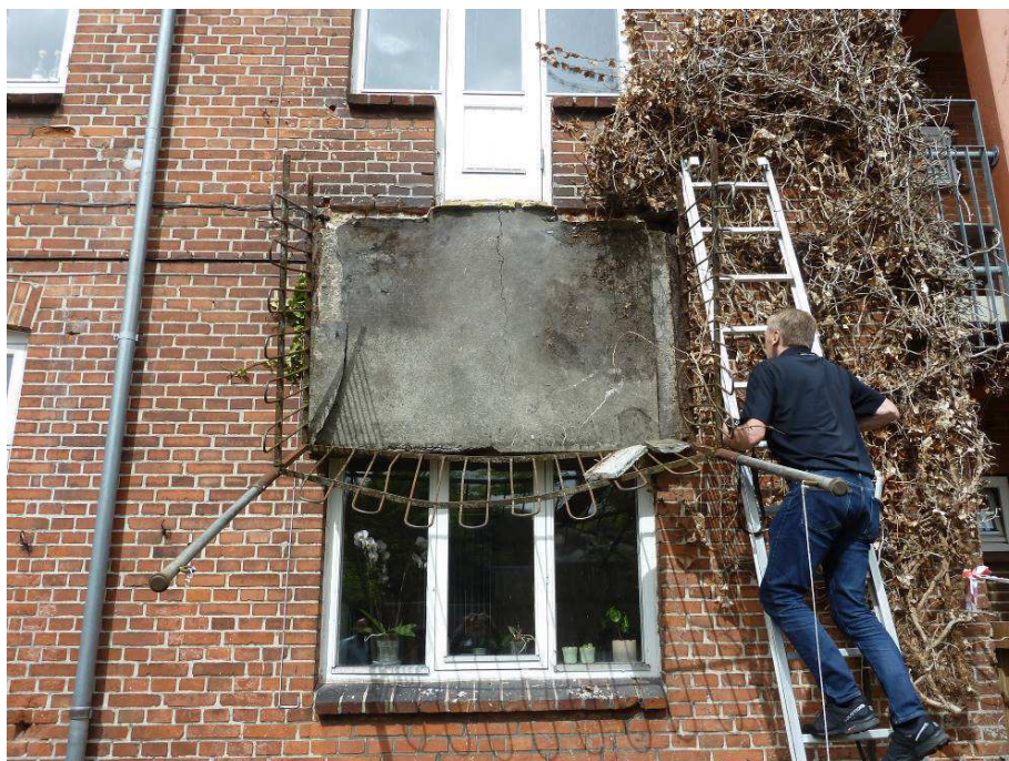
Figur 3. Facade med altan efter kollaps.
