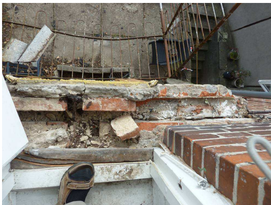
Figur 4. Foto fra altandøren. Man ser skaden på dørtrinnet samt mursten, som er trukket ud af muren som følge af at de er støbt fast i pudslaget.
