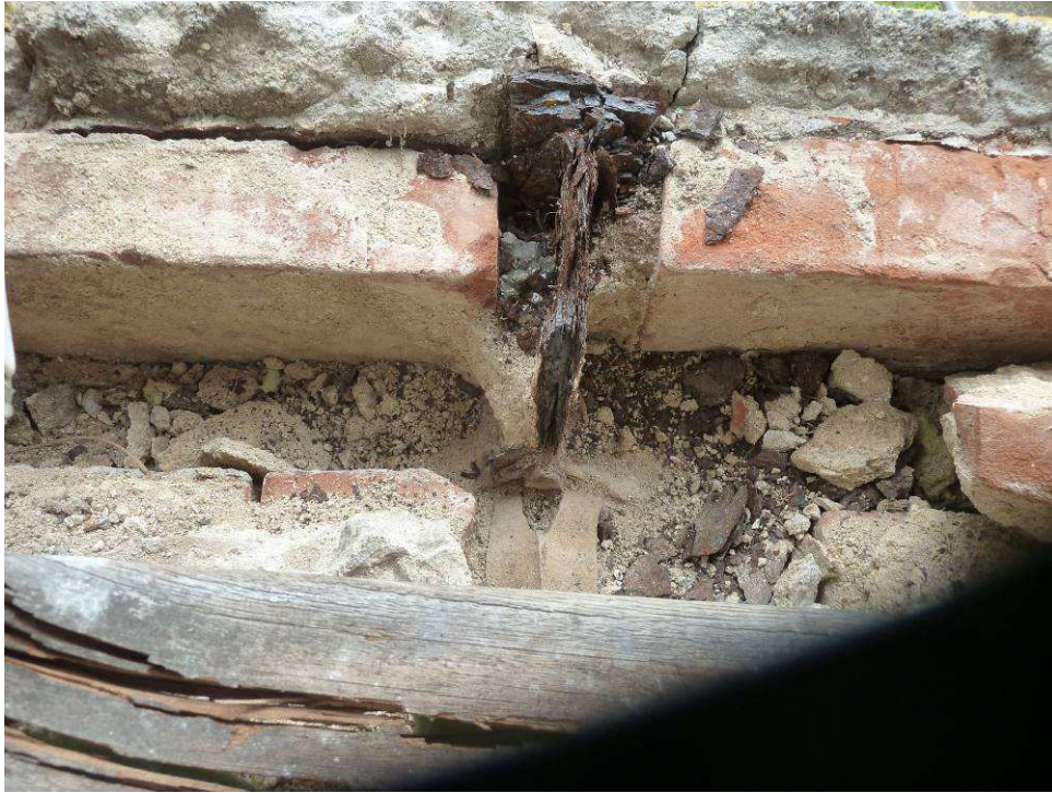
Figur 5. Brudsnittet i det midterste udliggerjern set mod altanpladen. Her ses den bøjede underflange samt korroderede dele af den øvrige del af tværsnittet. Det kan se ud som om overflangen har et friskt brud.
