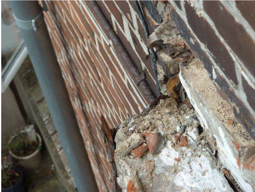
Figur 7. Brudsnittet i det venstre (set udefra) udliggerjern set mod altanpladen. Her ses det stærkt nedbrudte tværsnit.
