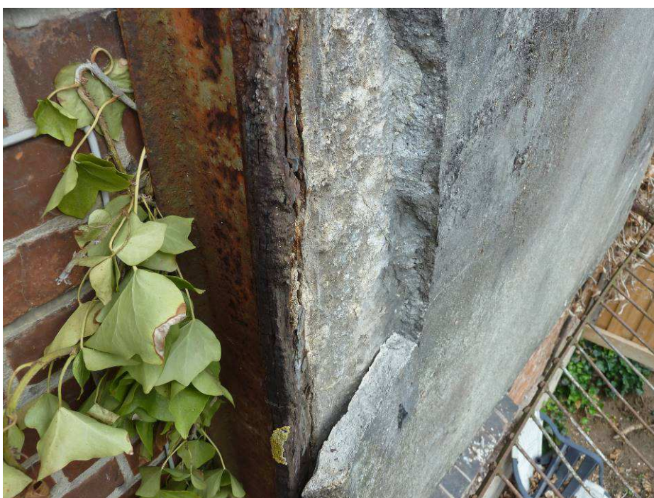
Figur 17. Venstre side (set udefra) af den kollapsede altanplade.
