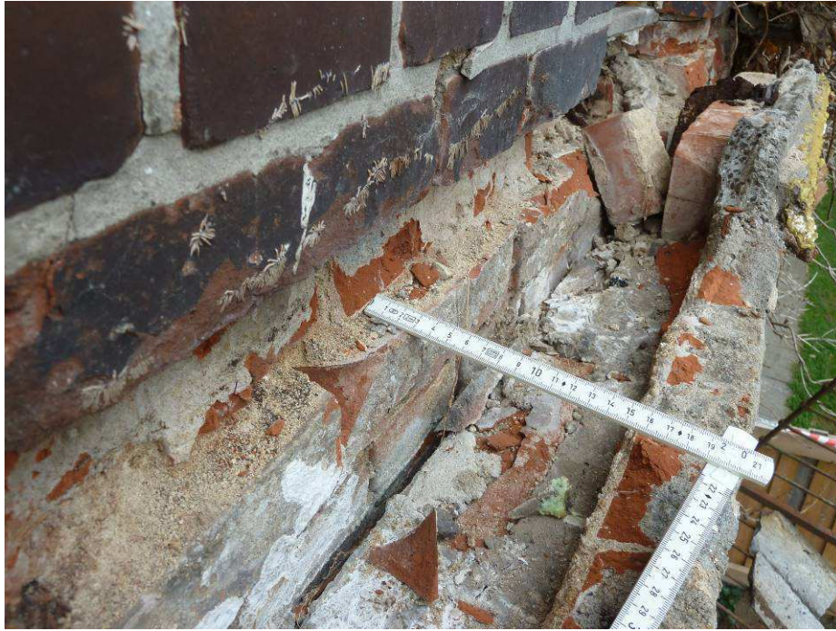
Figur 14. Man ser pudslag siddende på betonpladen og et hul i muren, ca. 30 mm dybt, hvor det har siddet i muren. Man ser endvidere friske brudflader i mursten og mørtel.
