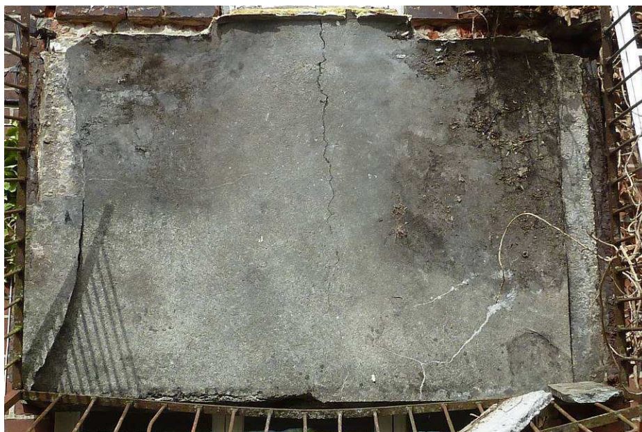
Figur 16. Oversiden af den kollapsede altanplade.
