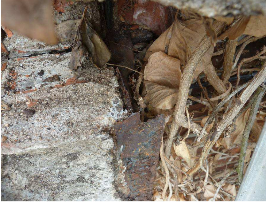
Figur 9. Brudsnittet i det højre (set udefra) udliggerjern set mod altanpladen. Her ses det stærkt nedbrudte tværsnit.
