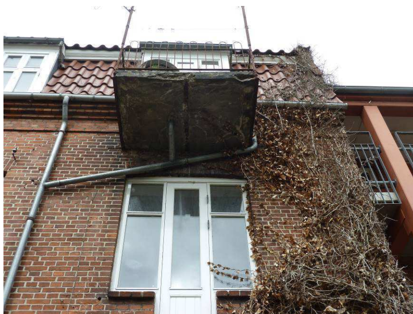
Figur 19. Altanen ovenover den kollapsede altan set nedefra.
