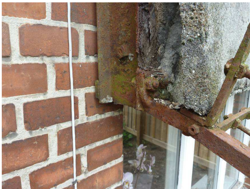
Figur 12. Detaljer fra et hjørne af altanen. Heraf fremgår fastgørelsen af rækværk til udliggerjern samt bolt til fastholdelse af trækbånd – boltene i den modsatte side var forsvundet.
