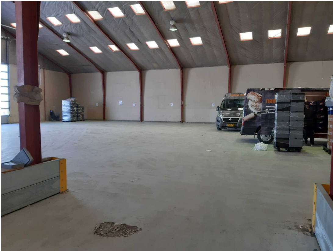
Her ses hullet i epoxygulvet mellem støttestøtterne.
