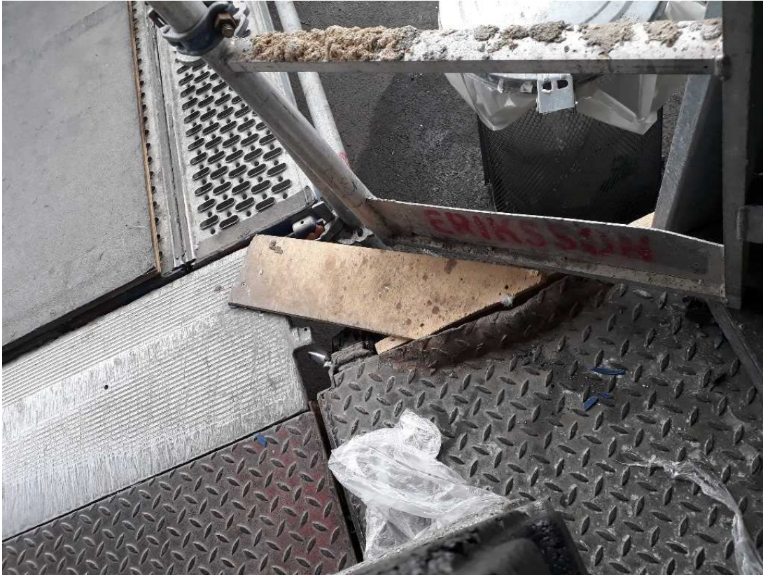
Overdækning med bræt af hul i rampe, hvor ansat fra RA Auto kom til skade, da han trådte ned i hullet
