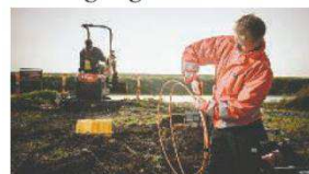
SE/Stofa har indtalt nu gravet fibernet ud til ca. 3.400 husstande på Ærø. Stofa fortsætter dette arbejde resten af 2016 og i 2017.
