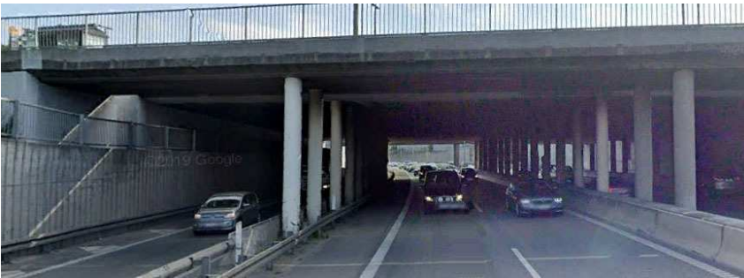
Figur 5.8 Motorring 3 set mod nord ved Lyngby Omfartsvej (St. 136.38 HS). Afstande mellem autoværnerne er 9,6 meter. Etablering af et ekstra kørespor vil kræve minimum 11 meter.
