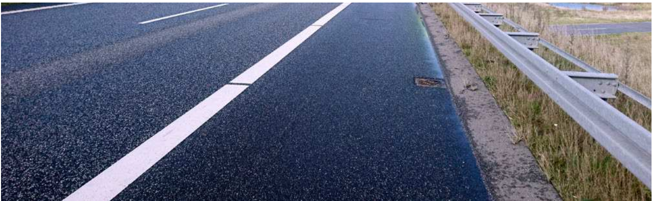
Kantopsamling med asfaltvulst
