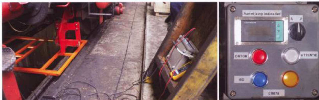
Links: het oranje frame dat op de rails ligt genereert, met behulp van de grijze kast die rechts zichtbaar is en codegever wordt genoemd, ATB-signalen die door de opneemspeel worden gelezen en doorgestuurd naar de centrale ATBE-unit. Dit frame wordt gebruikt op plaatsen waar geen ATB-signalen door de rail kunnen worden gestuurd om ze met een bekende stroomsterkte voor de kalibratie te simuleren. Rechts: de bedieningskast voor ATBE van loe 01 1075 zoals deze bij de plaats van de machinist is aangebracht. Linksboven zit een digitale snelheidsmeter, daarnaast een knop met de keuze vooruit of achteruit, om de relevante opneemspeel te activeren. De blauwe lamp geeft aan dat er op een traject gereden wordt zonder ATB, de witte lamp brandt als geredemd wordt en de rode wanneer het ATBE-systeem een remingreep heeft gedaan. De oranje lamp brandt bij vooruit rijden bij snelheden onder 40 km/u ten teken dat het systeem actief is. Dooft de lamp niet bij achteruit rijden of bij snelheden boven de 40 km/u, dan duidt dit op een defect in de installatie. Abraham Bot, SSN
