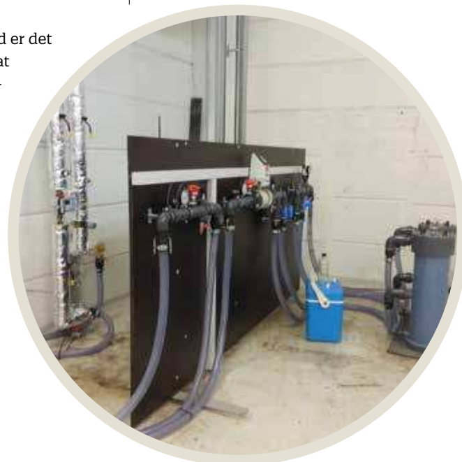
Recirkulationsanlæg og varmepumpe i forsøgsprojektet i Birkerød.
