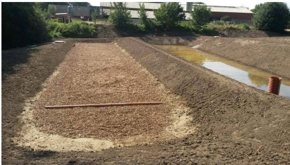
Nyanlagt minivådområde med matrice ved Fensholt, Odder. Anlægget har stuvningsbassin (til højre) og matricebassin. Foto: Susanne Brusvang Hjuler.
