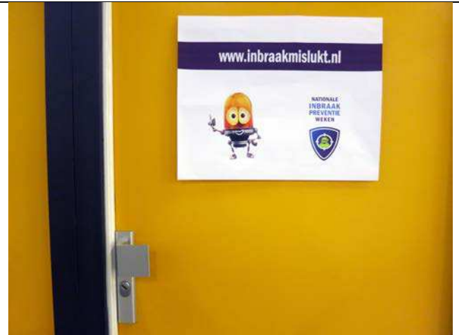
En officiel person fik til opgave at forsøge at bryde ned 4 døre op. Det gik nemt undtagen på denne dør, der lever op til nutidig PKVW standard. Bemærk sikring mod cylindertræk på låsebeslaget.
