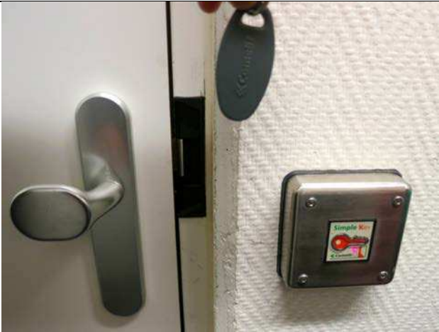
Elektronisk lås til dør til opbevaringsområdet (samme dør som på øverste højre billede). Den elektroniske nøgle ses øverst i billedet.
