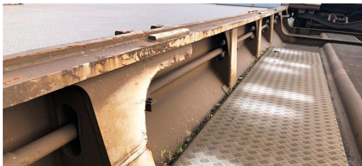
Figur 38: Skader på lommevognen
