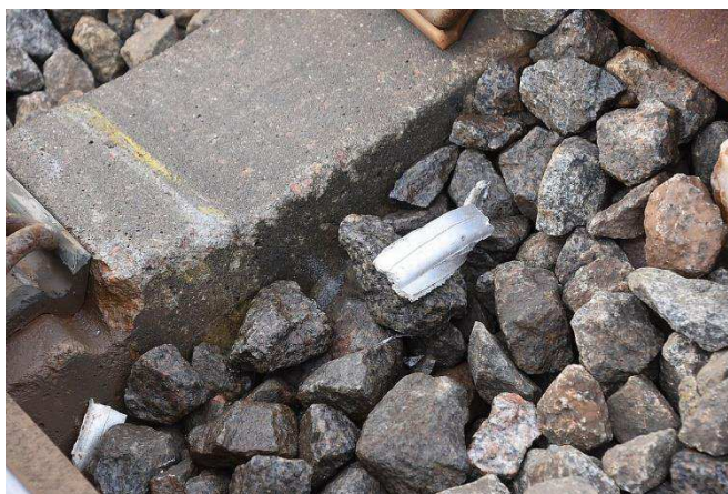
Figur 4: Km 126,691 letmetalstumper og gul afstribning fra trailers tagpresenning.
