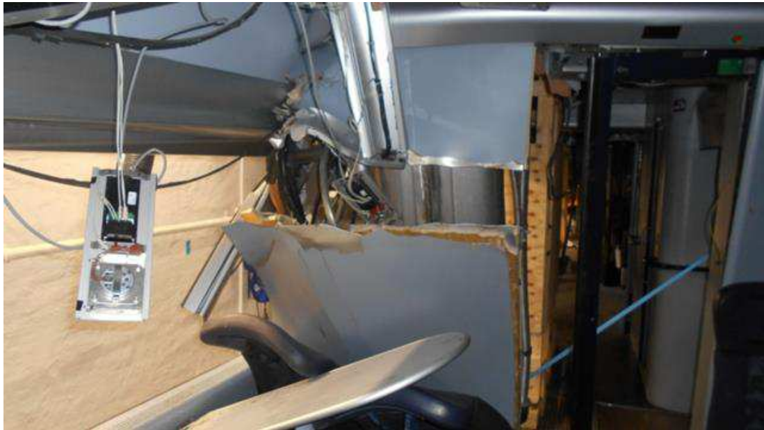
Figur 96: Sæderne 254 + 256 (vindue) bukket fremad af vægpanel
