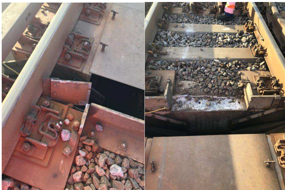
Figur 6: Km 126,740 og km 126,750. Skader på skinneudtræk i 1. hovedspor
