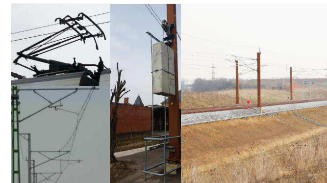
Figur 2.1. Eksempler på unikke løsninger på Siemens SICAT SX-systemet: Vridning af køreledninger, større træk på ledningerne og længere mellem masterne.
