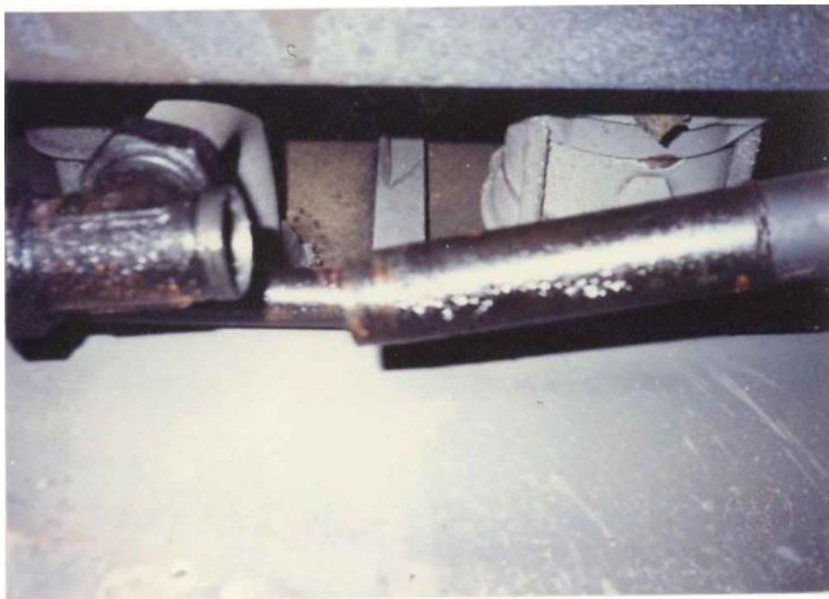
Foto nr. 1: Returolierøret med afgrening til betjeningspanel på bildæk. Røret trukket ud af skæringssamlingen til T-stykket.
