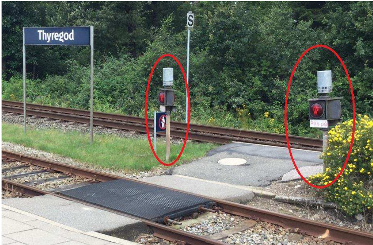
Billede 1: Varslingsanlæg på Thyregod Station med lys- og lydvarsling
