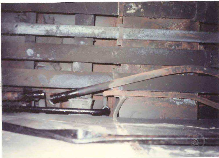
Foto nr. 2: Samme sted som foto nr. 1. Retur- olierøret er bukket.
