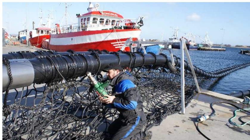
Figur 3.9 Efter færdigmontering blev SmartUnits lagt direkte ud i vandet. Kilde: Hjarnø Havbrug.
