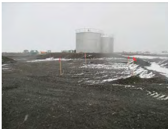
Foto 2 Tank 3 og 4 på det Sydlige Stationsområde.
