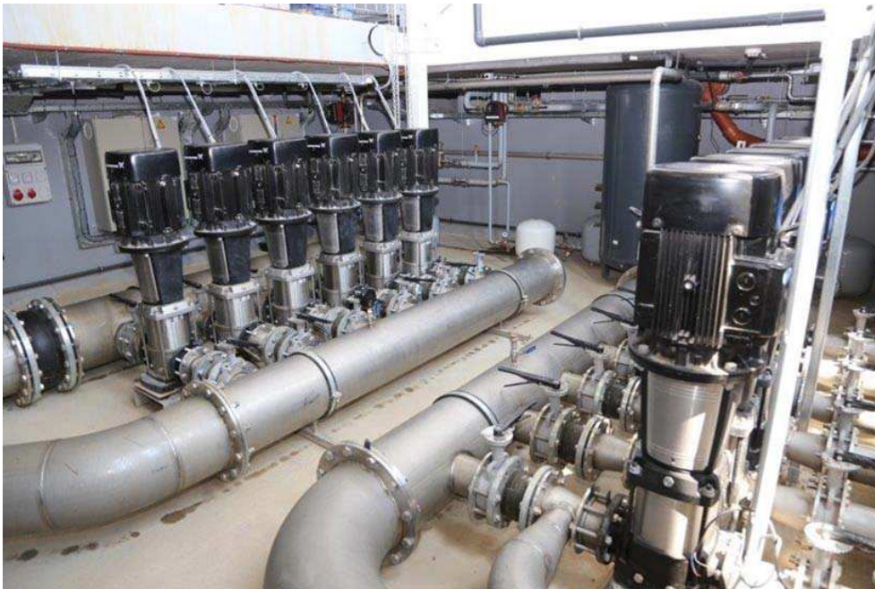
Foto 2 - Behandlingsmaskiner på rensningsanlægget Bogyiszló i Szekszárd (Ungarn)
