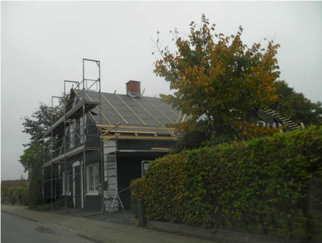
Dette stillads har fået kritik fra Arbejdstilsynet
