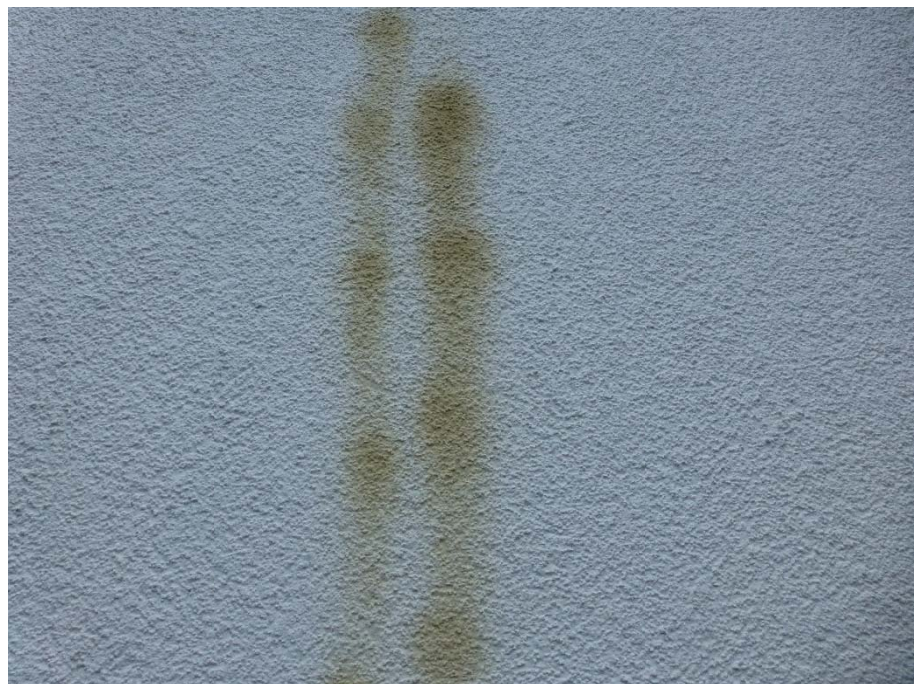
Figur 12: Opfugtning og misfarvning af puds-bærelplade på forskalling som opsuger MgCl_2 .
