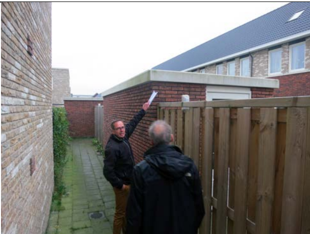
Bagsti med forkert placerede lamper. De sidder her ret langt inde på skuret og kan ikke lyse bagstien op, og bagstien har ingen anden belysning.
