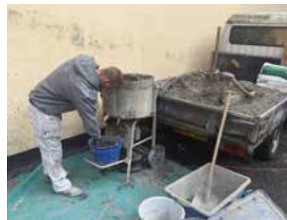
1. Der etableres en blandestation i baggården. Her fyldes fire spande med mørtel.
