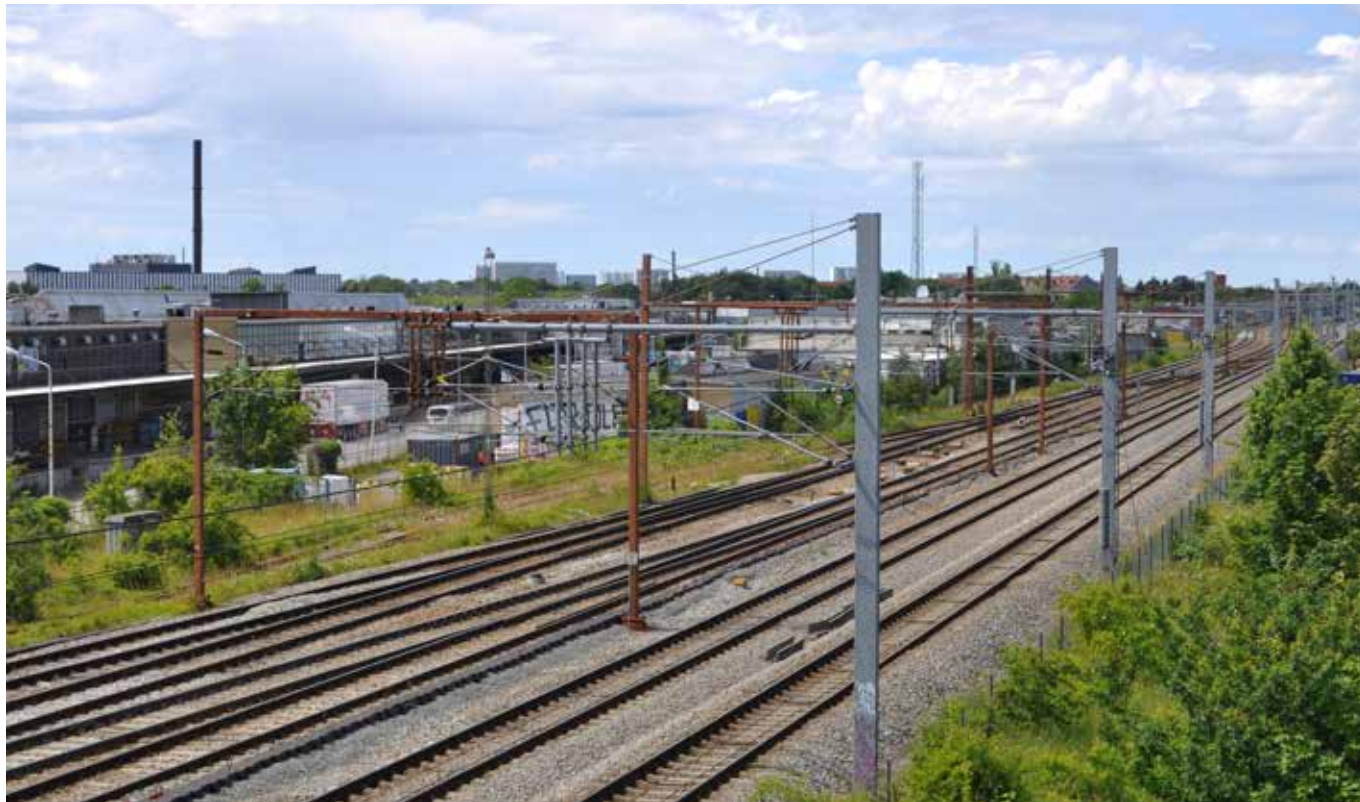
Området mellem Ny Ellebjerg Station og Vigerslev Allé Station, hvor udfletningen skal anlægges
