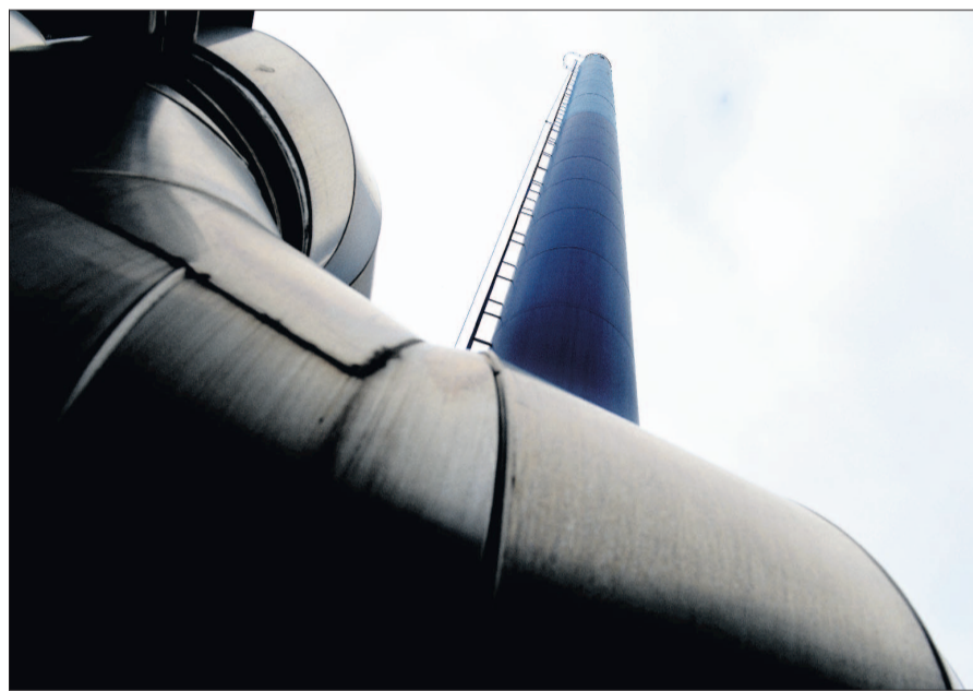
Nordborg Kraftvarmekværk kører efterhånden i begrænset omfang, fordi værket ofte ikke kan konkurrere med Østerlund Varmer A/S. Det bliver endnu sværere i fremtiden, når Østerlund Varmecentral kan producere varme på biobrændsel.
