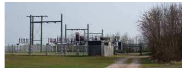
Foto 5.25 Transformatorstation. Teknikbygning ligger bag bevoksning i billedets højre side. Foto fra Nørhede ved Ringkøbing.
