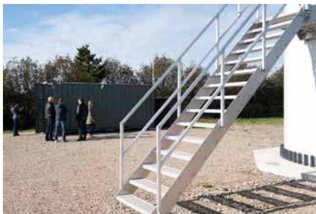
Foto 5.26 SCADA-anlæg ved vindmølle. Til højre for SCADA-anlægget, bag trappen til vindmøllen, skimter man en koblingsstation.
