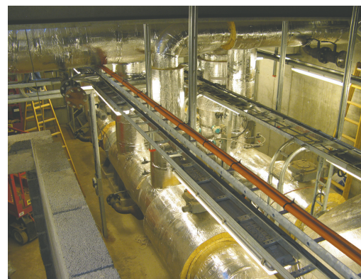
Den nye station på cirka 100 m 2 er et centralt knudepunkt for fordeling af VEKS' varme
