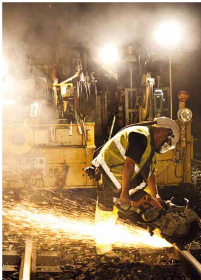
Udskiftning af skinner. Arbejdet foregår her om natten for at genere togdriften mindst muligt. Størsteparten af arbejdet på Vamdrup-Vojens vil dog foregå i dagtimerne.
