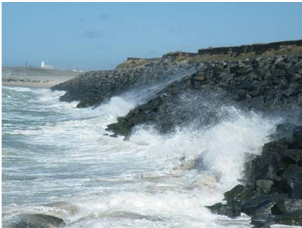
Her ser vi skråningsbeskyttelse med norske granitblokke ved hofde Q
