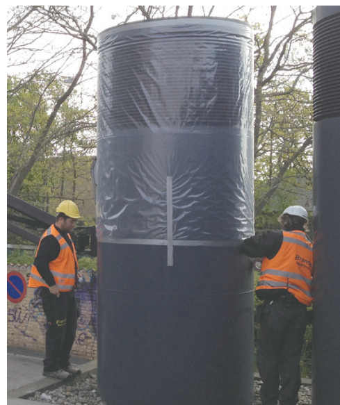
Afskærmning af indsugningen til VEKS-ventilationsanlæg
