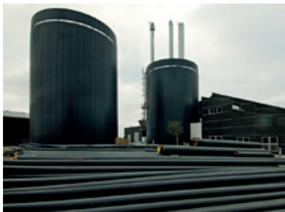
Fjernvarmerør ved decentralt dansk fjernvarmeværk. I baggrunden ses to akkumuleringstanke, der bruges til opbevaring af varmt fjernvarmevand
