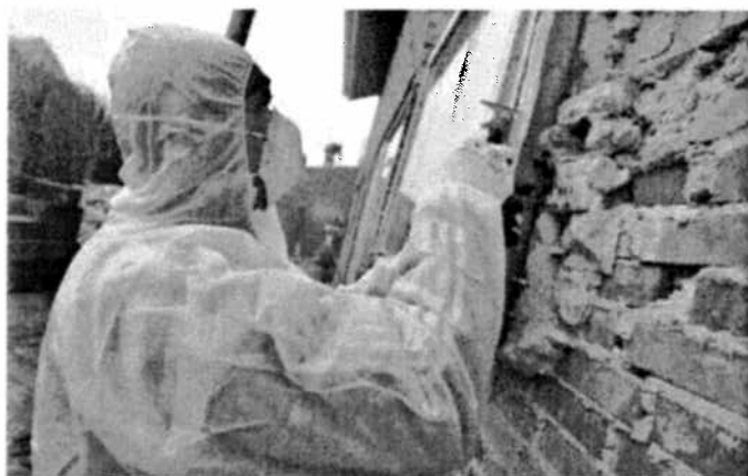
Man tager sine forholdsregler med PCB. Det gamle blødgøringsmiddel er frygtet for de problemer, det kan medføre - både for sundhed og økonomi. Foto: Scanpix
