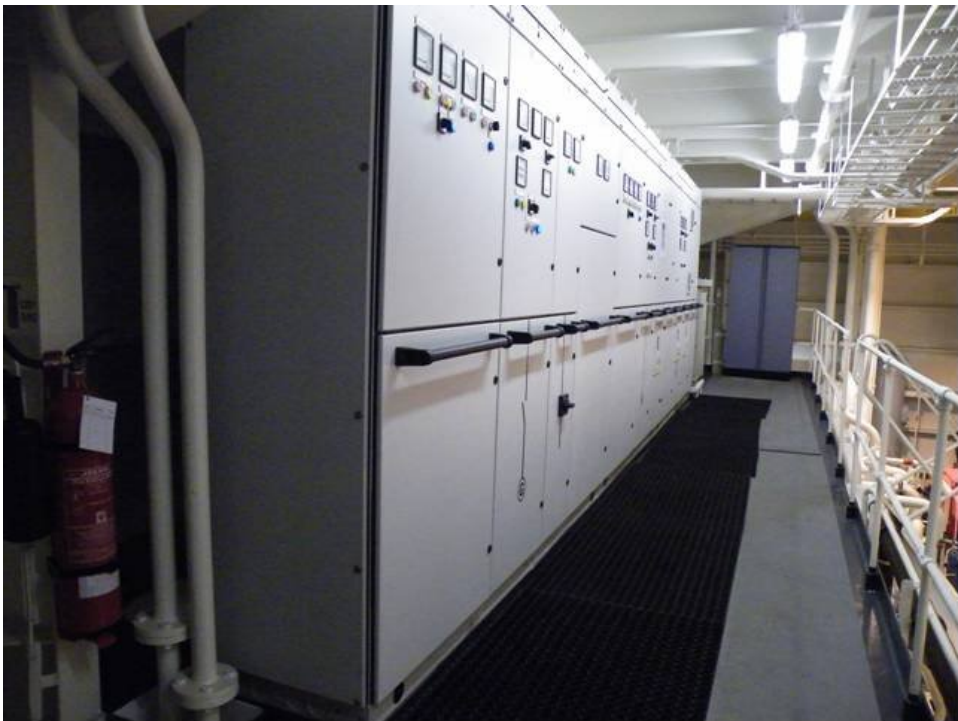
Alle pumper og fremdrift er baseret på elektromotorer, som styres via denne store EL tavle
