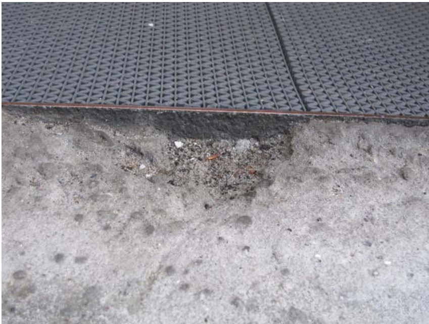
Fig. 3 – Hul i betonen ved indgangsdøren
