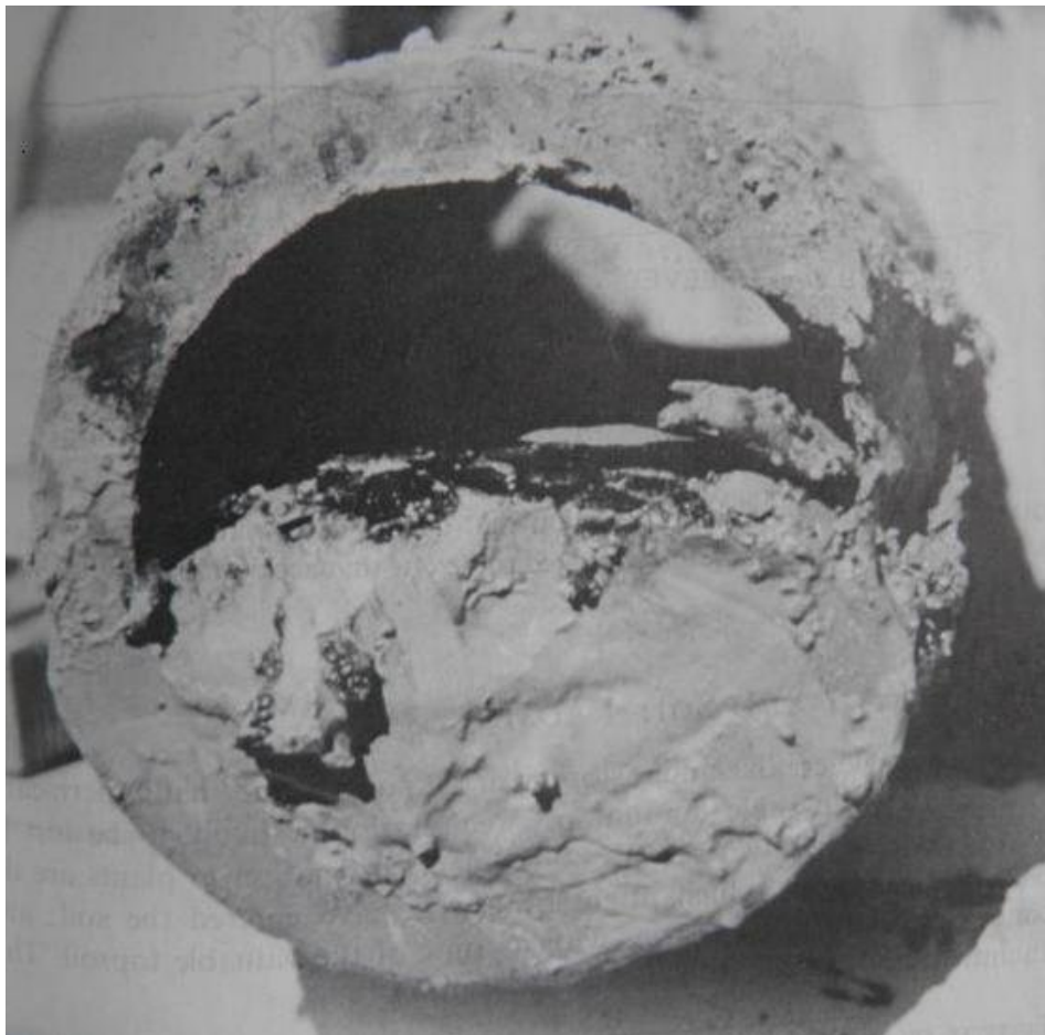
Figur 15. Drænrør, delvist tilstoppet på grund af sedimentation; dårlige udløbsforhold. 143
