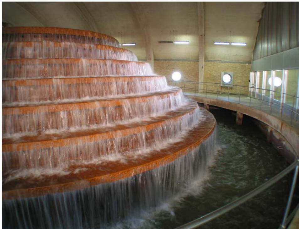
Iltningsstrappe på vandværk. Foto: Region hovedstaden.
