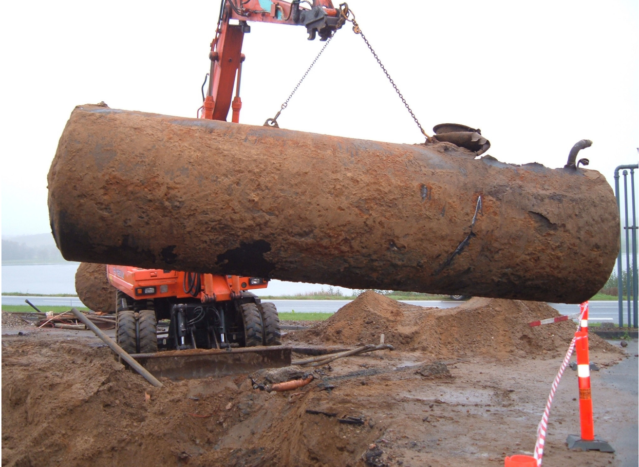
Opgravning af benzintank i forbindelse med oprensning af forurening på en nedlagt tankstation.
