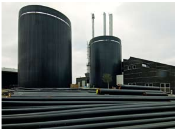
Fjernvarmerør ved decentralt dansk fjernvarmeverk. I baggrunden ses to akkumuleringstanke, der bruges til opbevaring af varmt fjernvarmevand
