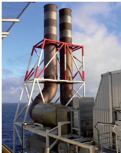
Afgangsrør fra gasturbine på Syd Arne platformen.
